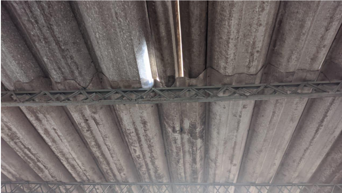
FOTO 4 - Telha de fibrocimento danificada
