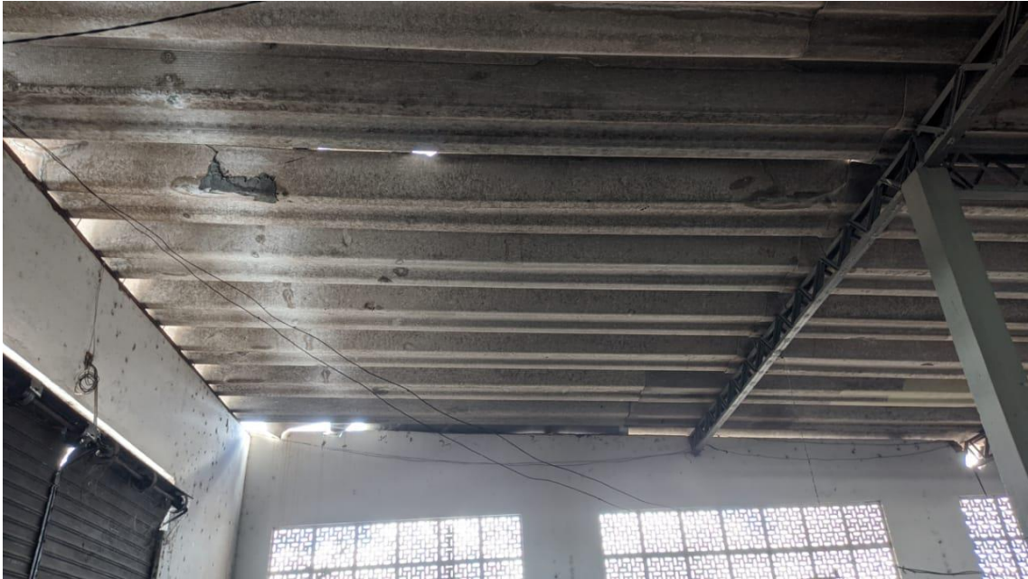
FOTO 2 – Telha de fibrocimento danificada
